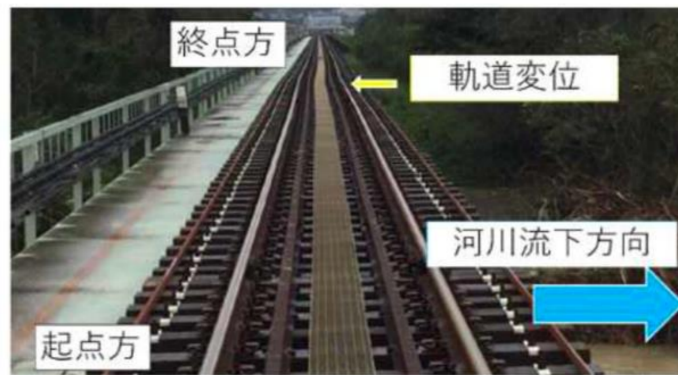
左図：鉄道車両通過時の遅れ変位による橋りょうの変位(神流川橋梁) 出典：「八高線神流川橋りょうで発生した橋脚洗掘の原因と対策」(丸山ほか)
