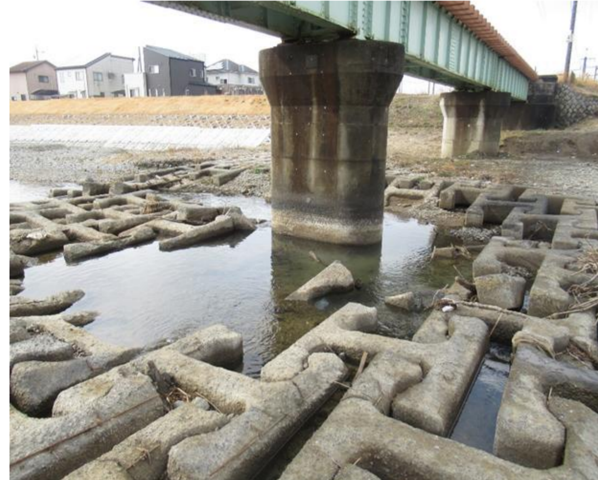
ブロックが変状・流出している様子(JR東日本提供)
