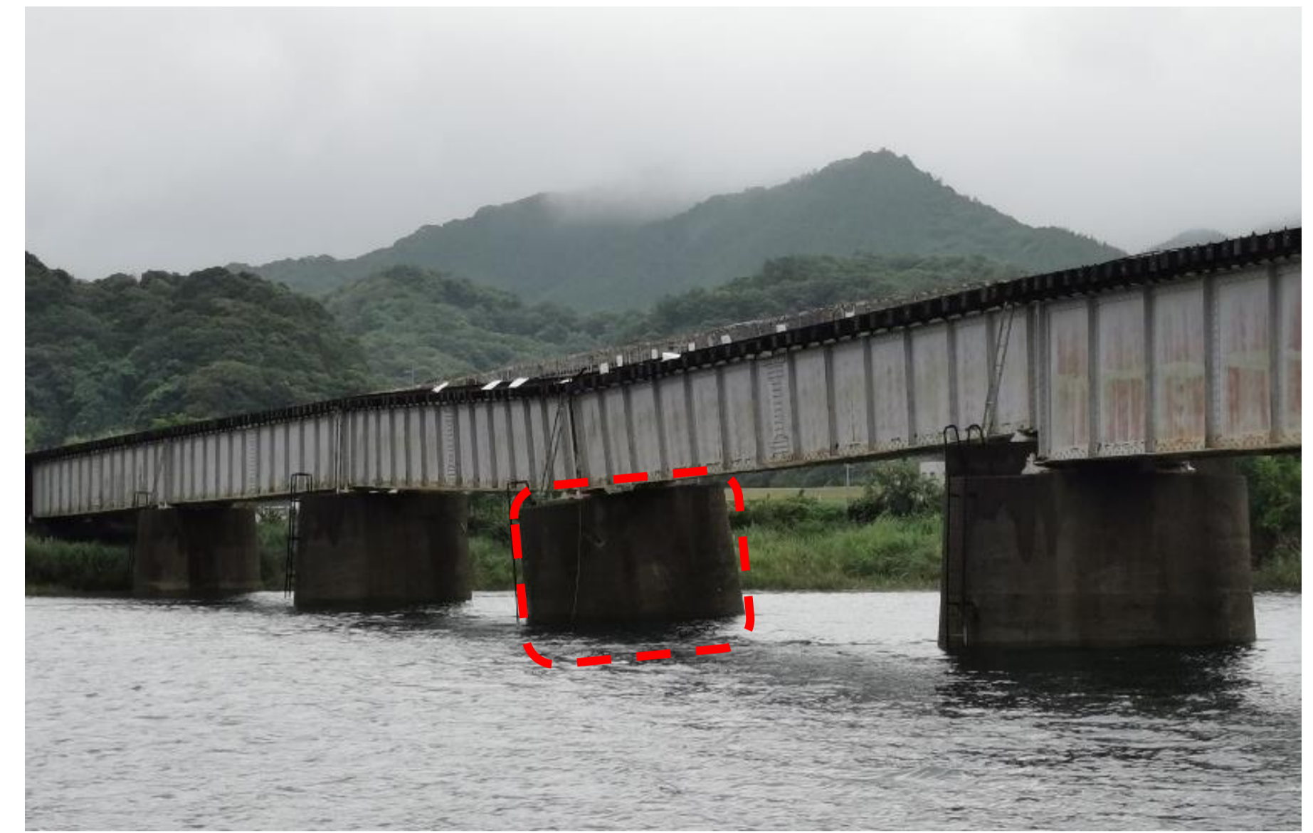
局所洗掘による橋脚の被災(山口県 栗野川橋梁、2023年7月19日撮影)
