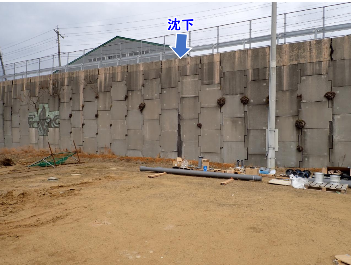
パネルの目開きが見られる
