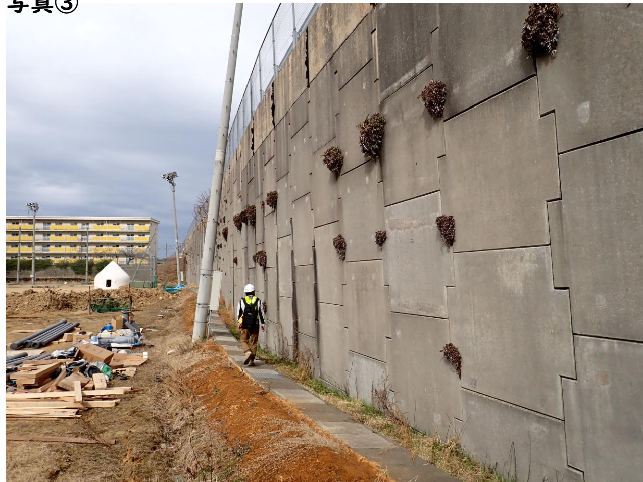
補強土擁壁全体が滑動変位し、擁壁前面の根入れ部分が前面受働破壊し、隆起している。これに伴い、電柱および排水溝のトラフは壁に向かって傾斜している。
