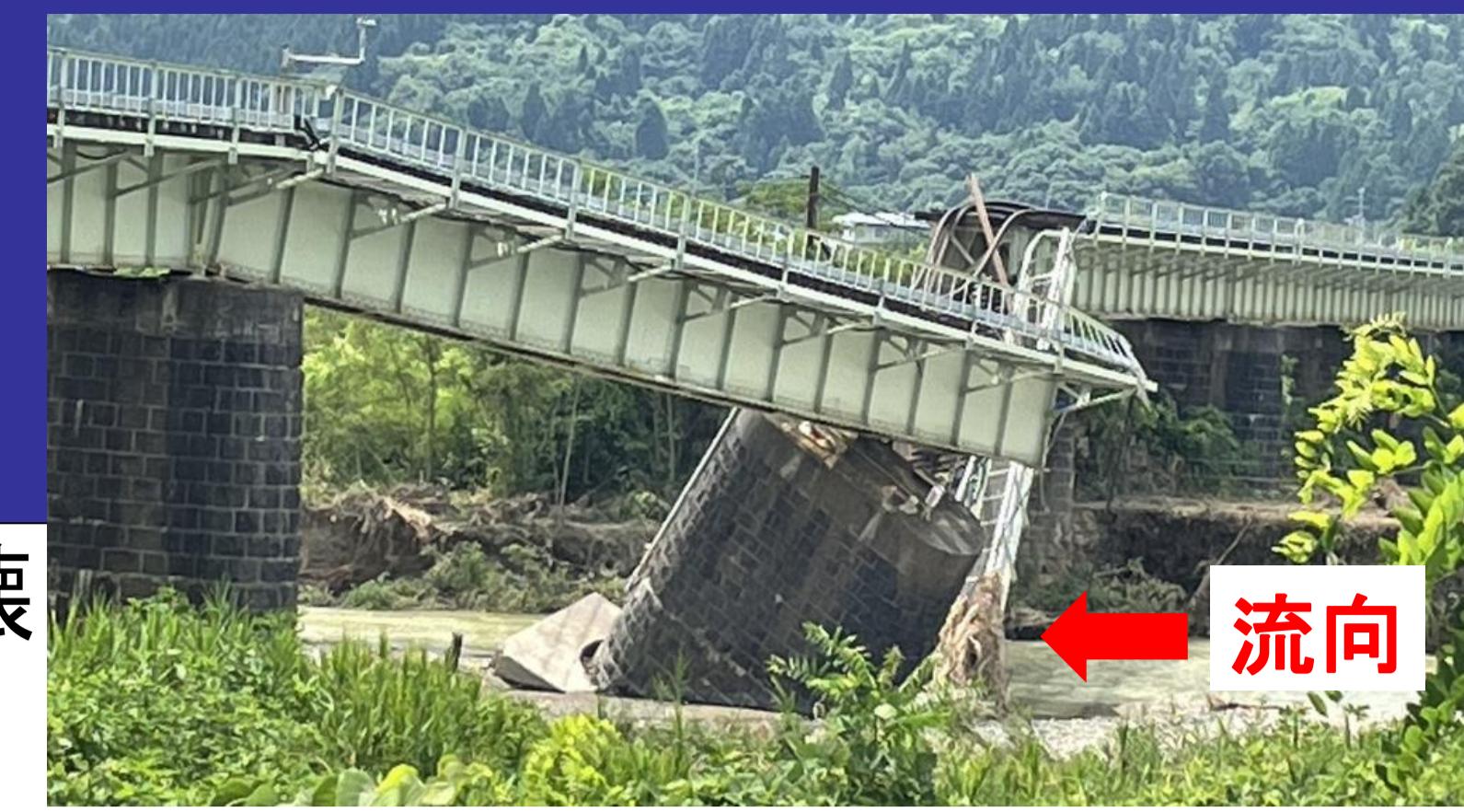
令和4年8月に中規模出水で被災した濁川橋梁(JR磐越西線)
